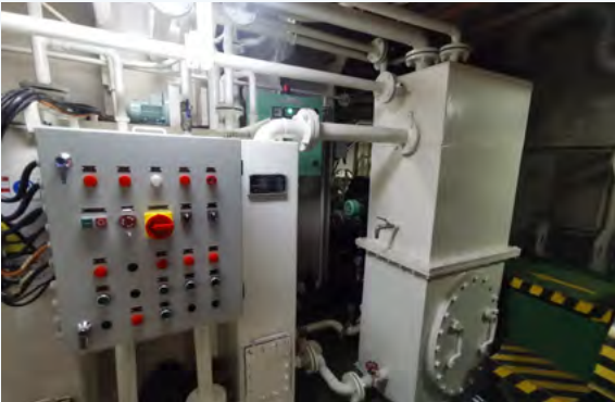
生活污水处理装置升级
