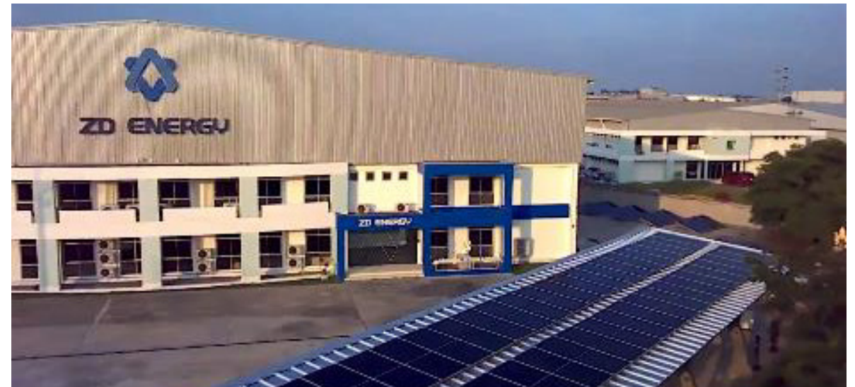
泰國工廠車棚光伏電站
