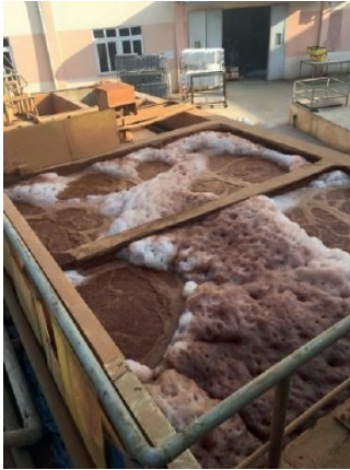
J.Y. Plasteel 透過微生物處理生活污水
