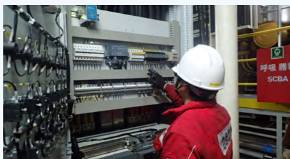
岸电系统运行前检查
