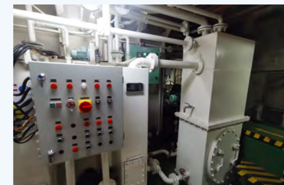
生活污水处理装置升级
