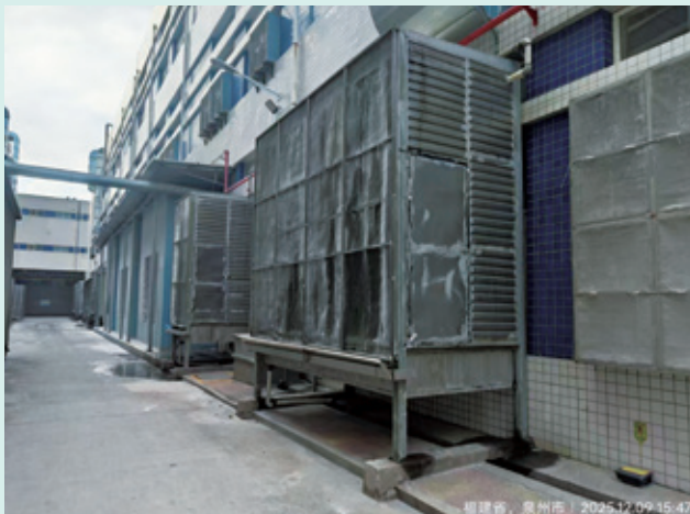
Wet Scrubbers 水幕機設備
