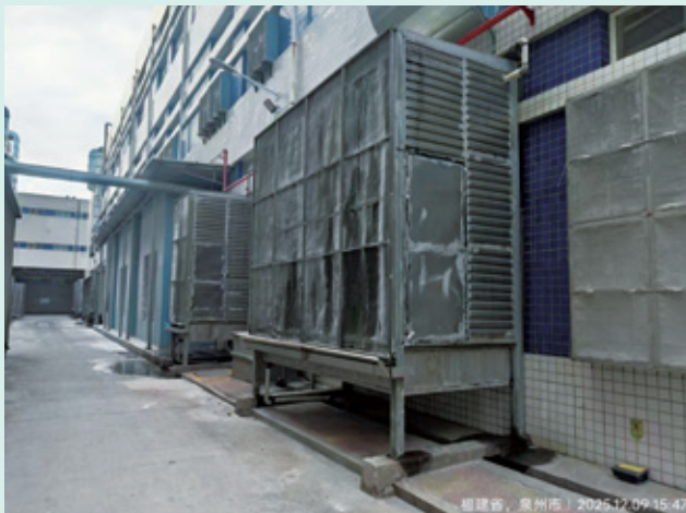
Wet Scrubbers 水幕機設備
