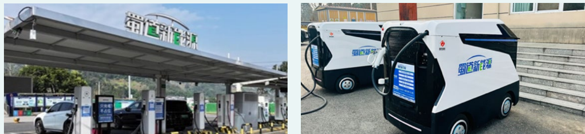
公司新能源充電設施
