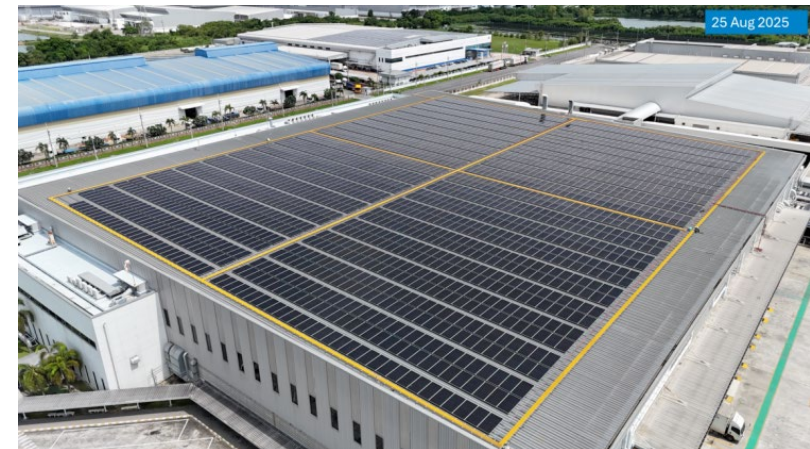
均勝安全泰國工廠光伏項目
