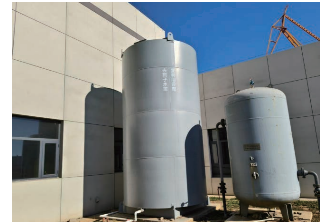
重裝公司水循環設備
