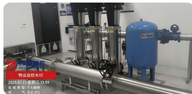
水泵节能优化更新设备
