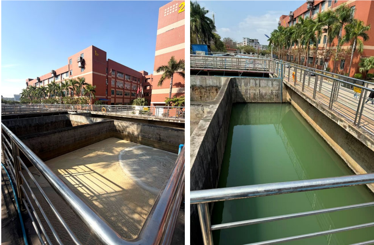
照片：現場廢水處理系統
