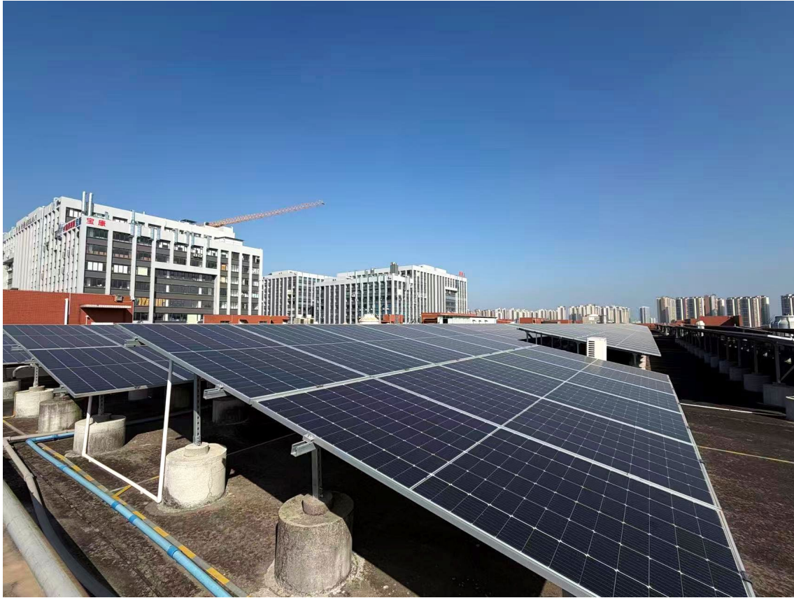
照片：屋頂光伏裝置
