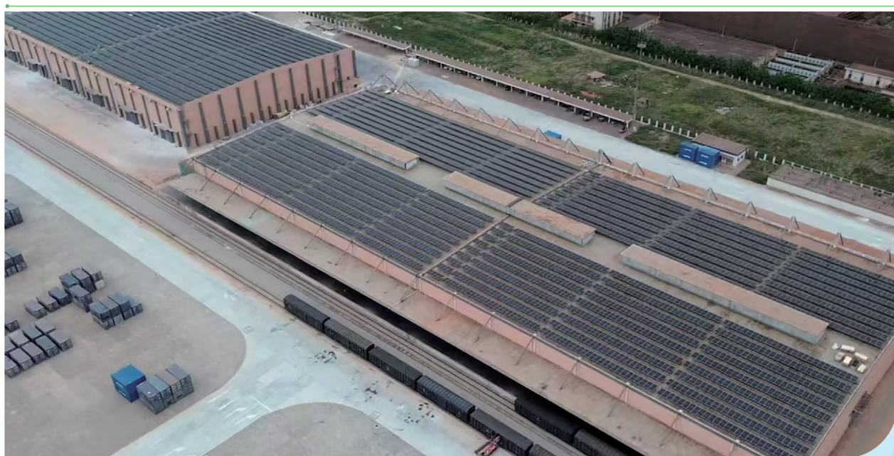
本集團分佈式光伏項目現場
