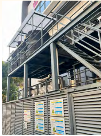
藥明巨諾蘇州生產基地廢水處理站
