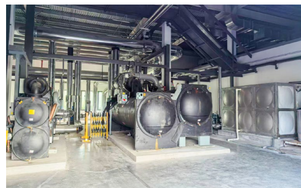
萊蕪工廠地源熱泵系統
