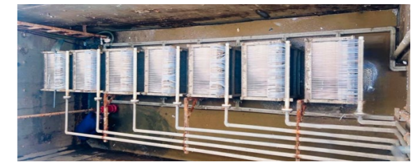
污水處理站生物膜系統更新
