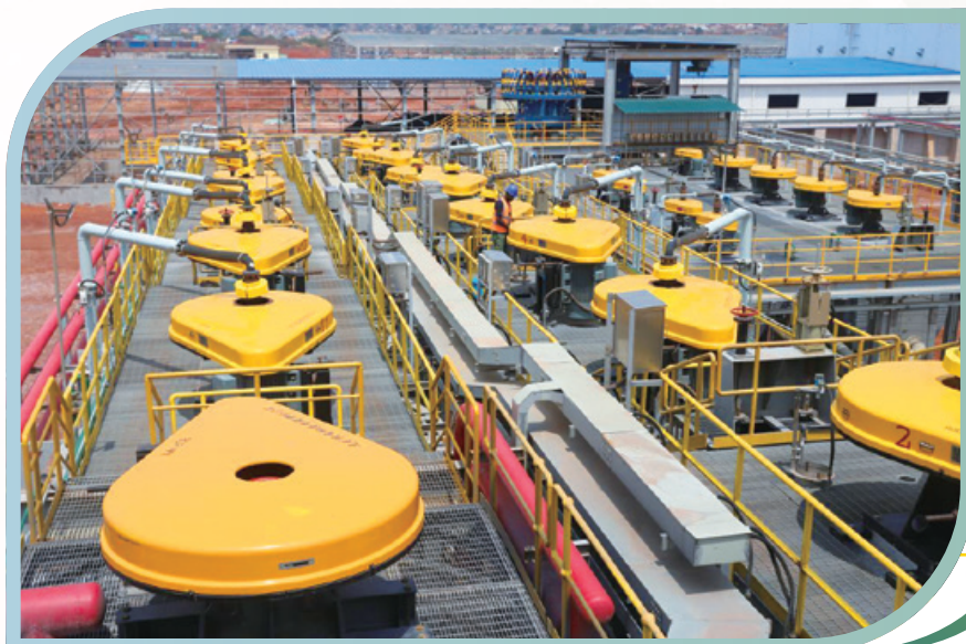
Musonoi Mine - Flotation Platform Musonoi礦場 - 浮選平台
