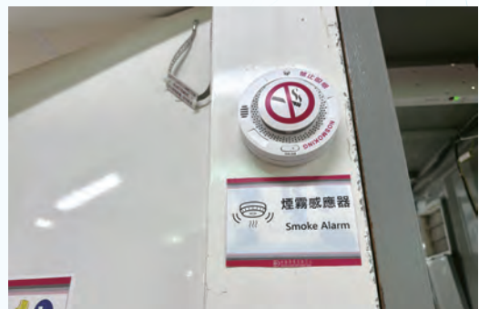
在地盤範圍內安裝煙霧感應器。
