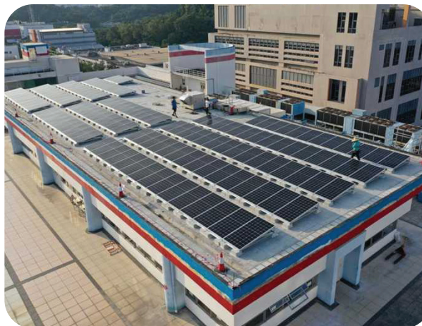
於香港南順大廈屋頂安裝的220千瓦太陽能光伏組件
