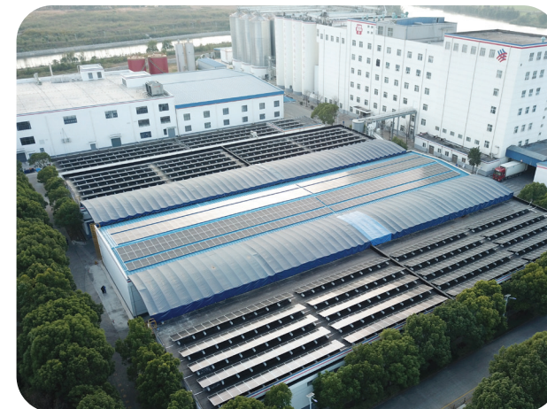
於金壇麵粉廠安裝的0.7兆瓦的太陽能光伏組件
